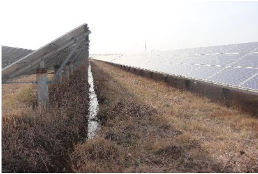
光伏板区截水沟
